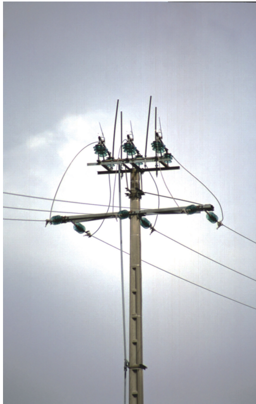
Poteau équipé du système « dissuasion »
