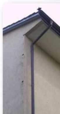
Dégâts causés par des pics
