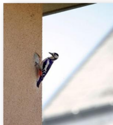
Pic épeiche creusant un mur d'une maison
