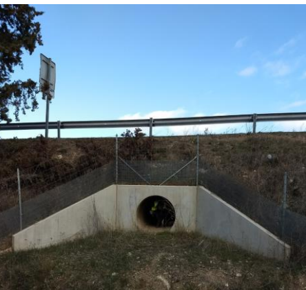
Entrée de l'écoduc sous l'autoroute A7 dans le bocage du pays salonais © Aurélie Johanet
