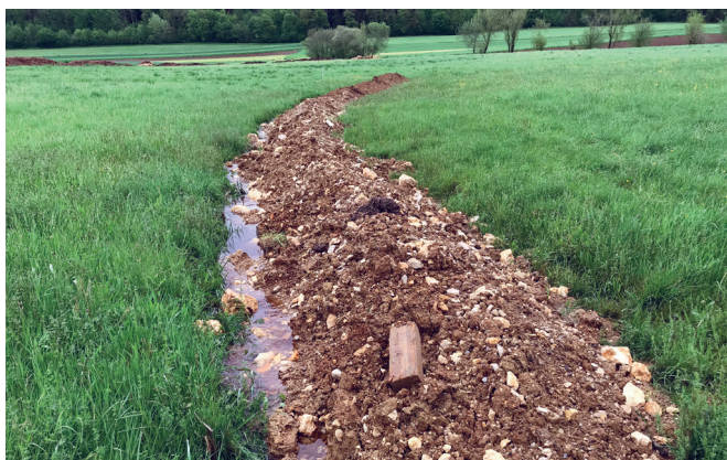
Fig. 4. Une partie du ruisseau a été comblé, Lugnez, Prés du Fossé, 11.5.21.
