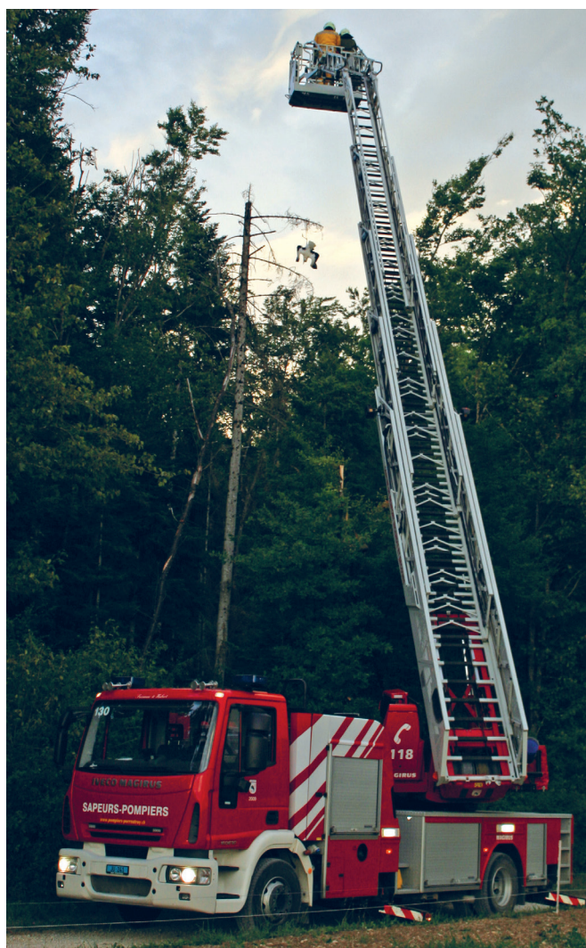
Fig. 10 b. Les pompiers de Porrentruy à l'oeuvre, 1.8.22
